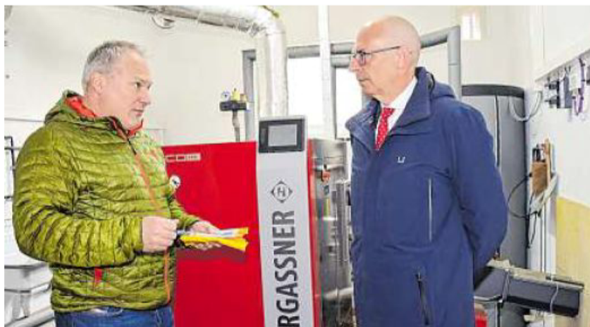
Mit ihrem Nahwärmenetz setzen Katja und Michael Hagel Zeichen. Zum Beheizen ihres Wohnhauses und der Gastwirtschaft in Dittersbrunn bauten sie im Jahr 2021 in einer rund 100 Meter entfernten Halle eine Hackschnitzelheizung mit einer Heizleistung von 49 kW ein. Landrat Christian Meißner (re.) ließ sich von Michael Hagel Details erklären. FOTO: MONIKA SCHÜTZ
